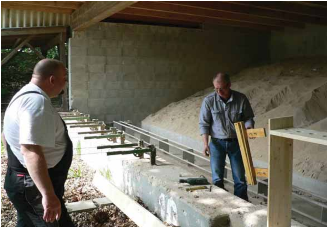
eine Halterung für die "Hilfsscheibe" auf der Bahn 10
